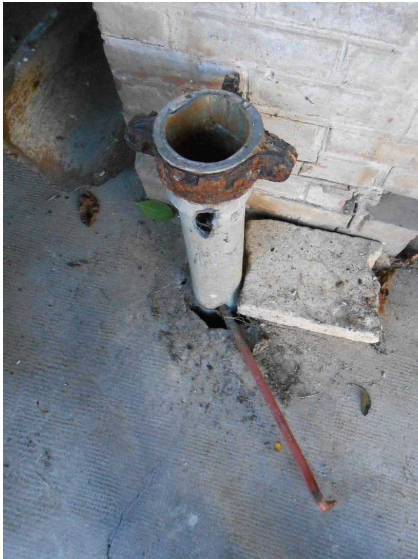
Photographie 18 : Puits sur site
